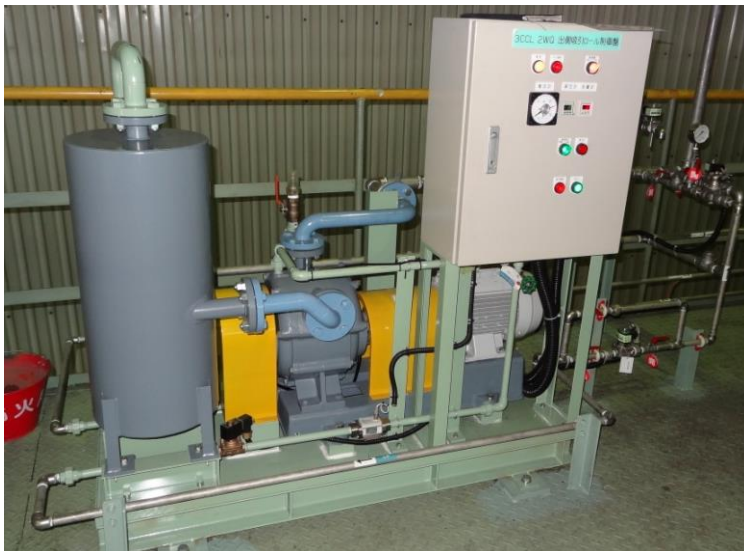
Conjunto de bomba de Vácuo
